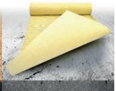
Colocación en pavimento agrietado
